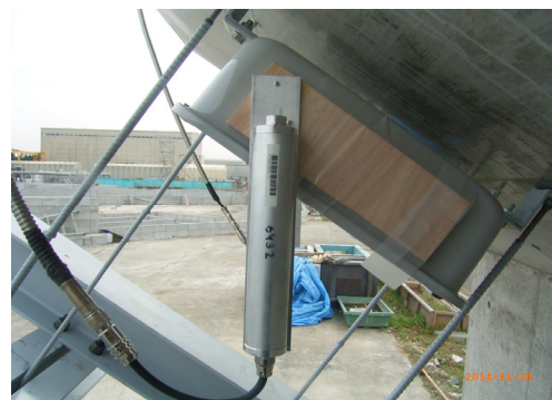
写真-3 傾斜センサー（IT孔内傾斜計）
